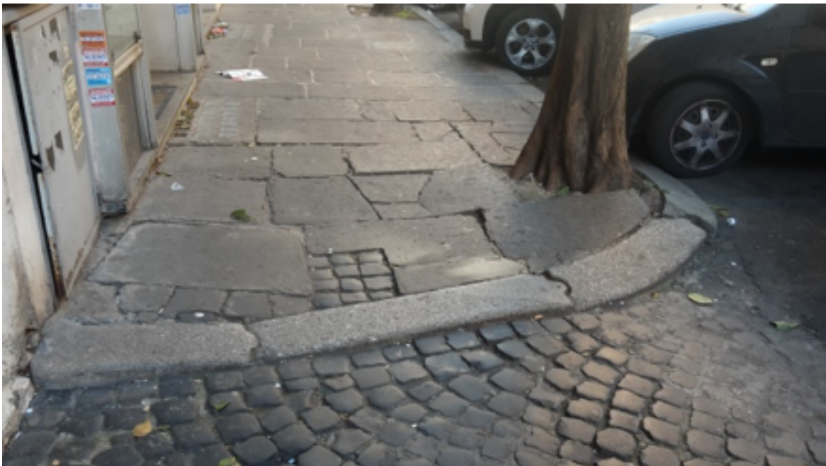
Foto n. 3 MARCIAPIEDI DEGRADATI E SCONESSI
